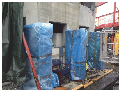
Midlertidig plassering av heisstyringer
